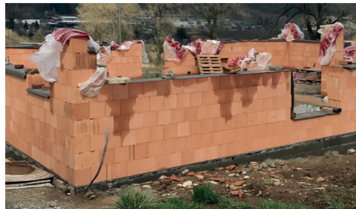
Obr. 43 – Někdy i přes dobrou snahu zdivo zakrývat může dojít při hnaném dešti k promáčení cihel (oproti zcela nezakrytému zdivu došlo k promáčení jen na lici zdiva a ne v celém průřezu)
