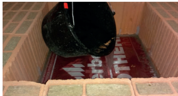
Obr. 8 Voda na základové desce v kontaktu s obvodovým zdivem
