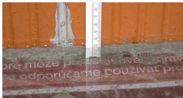
Obr. 9 Výška hladiny vody uvnitř stavby, styčné spáry zatmeleny silikonem do výšky cca 50 mm
